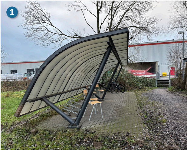
Abb. 117: Abstellanlage 1 (Foto: Ge-Komm GmbH)
