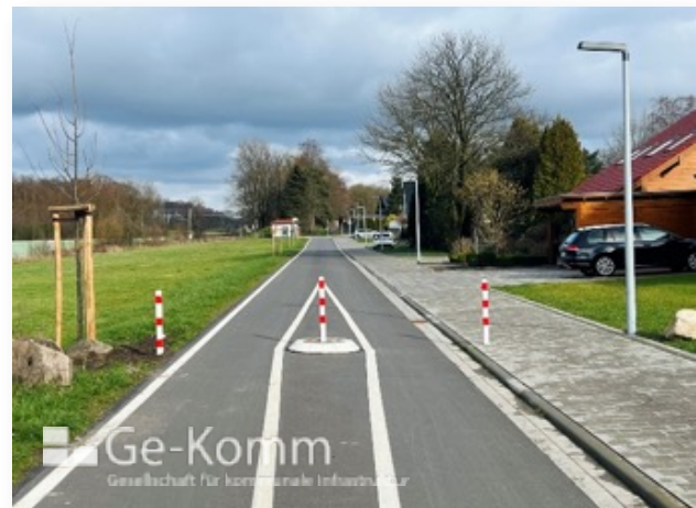
Abb. 96: Sperrpfosten (Foto: Ge-Komm GmbH)
